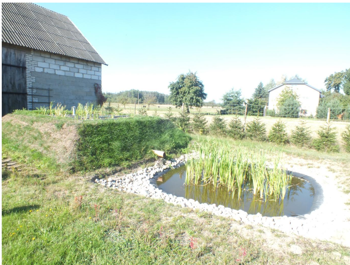
Rysunek 25. Oczyszczalnia hydrofitowa z podpowierzchniowym pionowym przepływem ścieków (źródło: zdjęcie własne, 2014r.)
