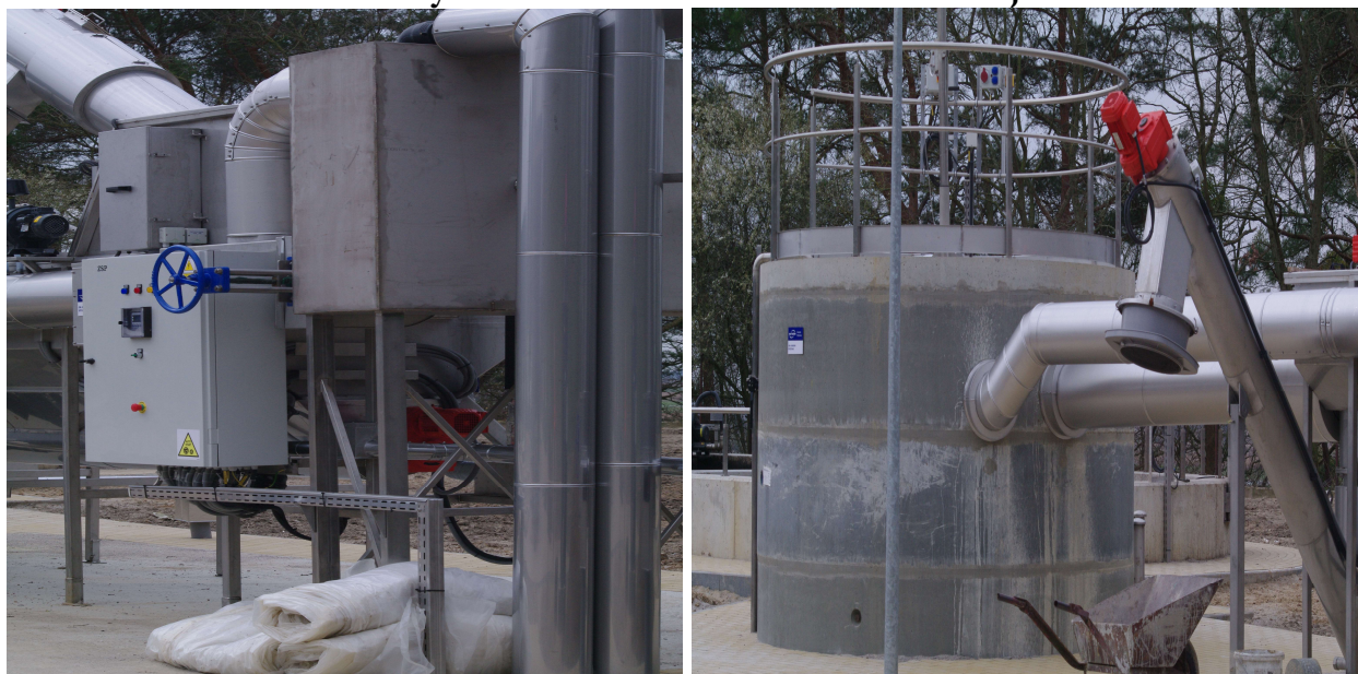
Oczyszczalnia ścieków w Widuchowej
